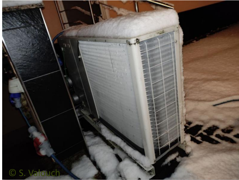
Wärmetauscher am Außengerät friert mit der Zeit zu
